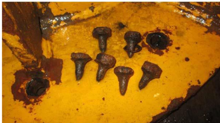
Parafuso falhados por corrosão 3
